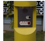
Panel de control, teléfono de emergencia
