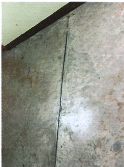
Desnivel entre losas en sobre terreno (Area de carga y descarga) debido a asentamiento de terreno
