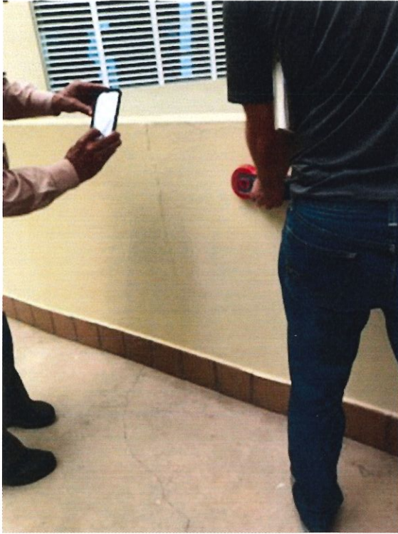
Grieta pre-existente en baranda de hormigón debido a encogimiento de hormigón
