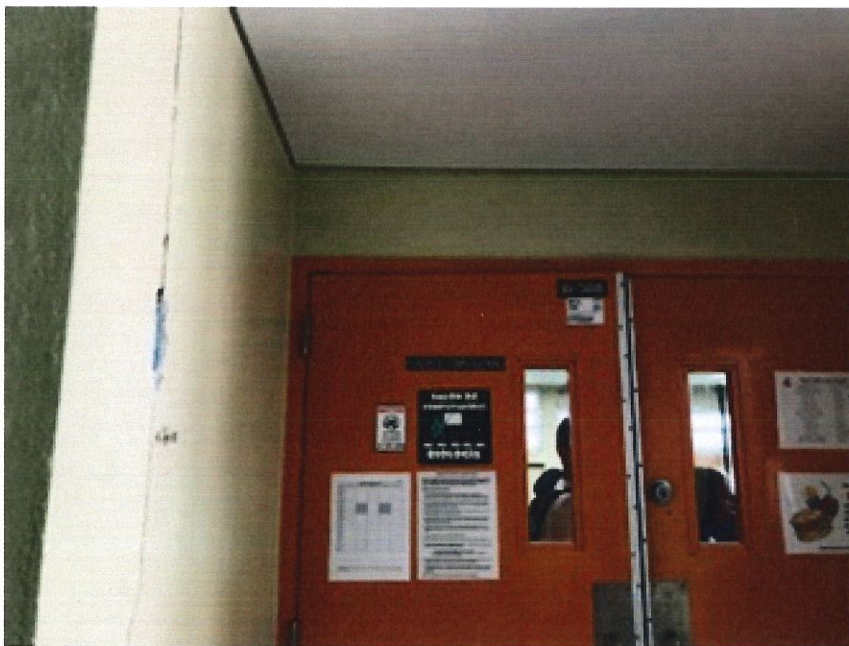
Separación en unión de columna y pared de bloque
