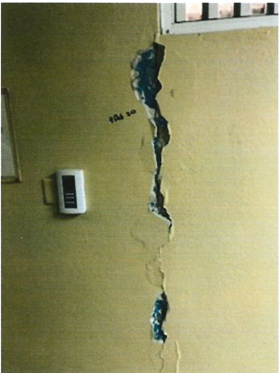
Grieta típica donde termina la malla de refuerzo del empañetado
