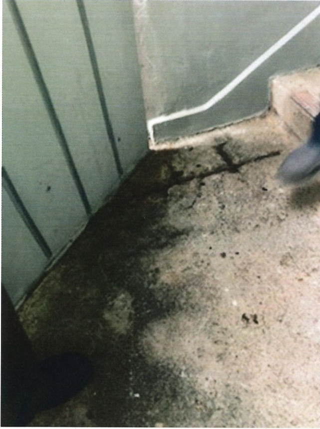
Varilla expuesta en losa de descanso de escaleras
