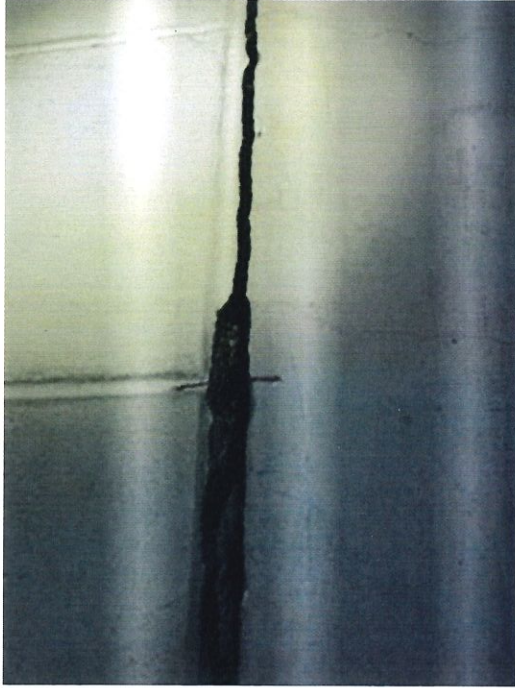
Desprendimiento de material en junta entre columna y pared de bloque
