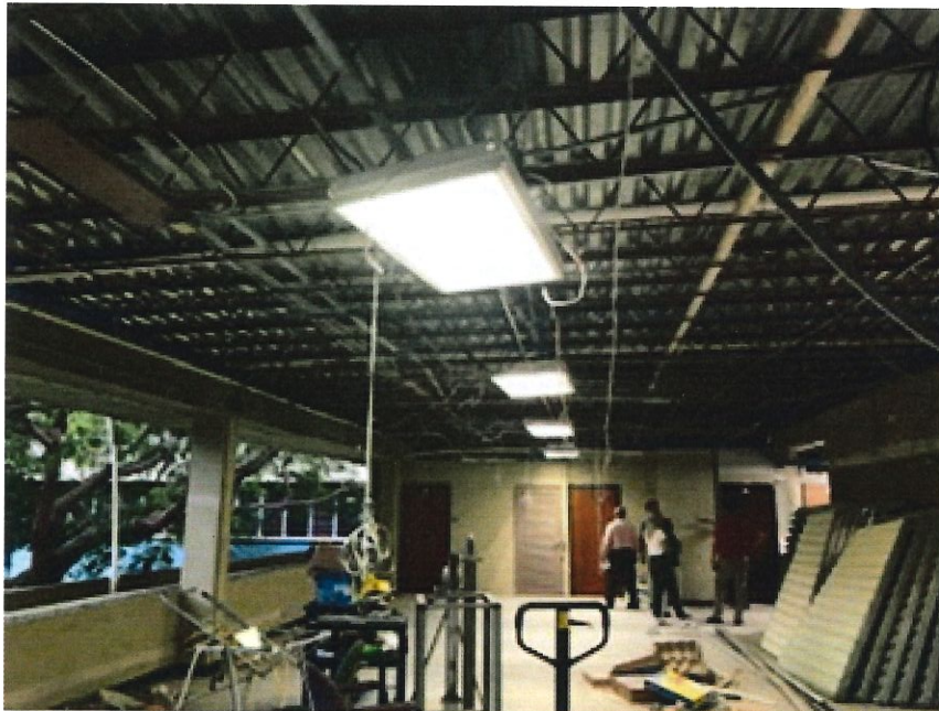
Viguetas de acero sin elementos de refuerzo en dirección longitudinal (bridging)
