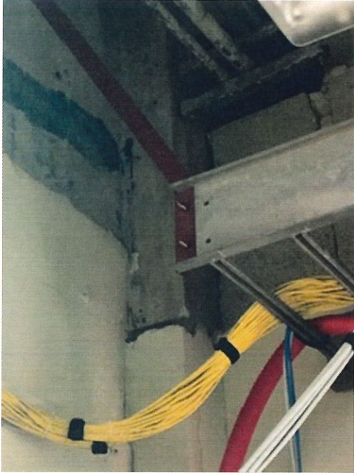
Ladrillos de hormigón colocados sin amarre ni viga de coronación
