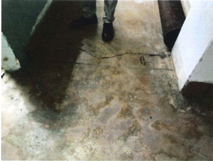
Grieta en unión de rampa sobre terreno y área de carga y descarga debido a asentamiento de terreno
