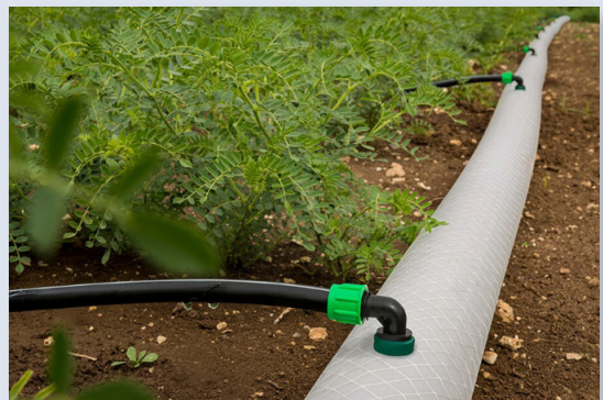
Foto 32. Tubería flexible y “fittings” para distribución secundaria. Tomado de Rivulis, Kibbutz Gvat, Jezreel Valley, Israel.
