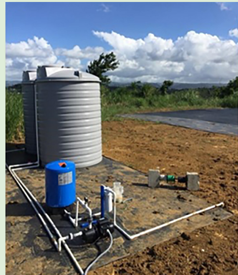
Foto 3. Dos cisternas de 1,000 galones con sistema de bombeo para riego por goteo en producción comercial a pequeña escala en Finca Agraria, LLC en Toa Alta. Tomada por Agro. Gustavo A. Rodríguez. Universidad de Puerto Rico.
